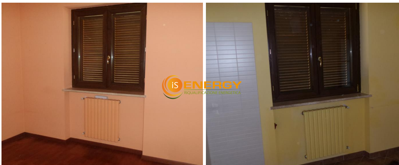
Radiatori sottofinestra: nicchia da 14 cm circa (ponte termico pesante)
