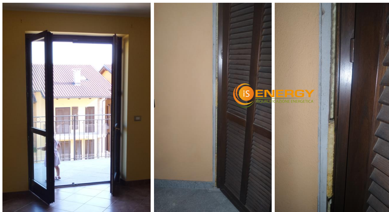
Infissi in legno: vetrocamera 4-12-4 con errore di posa (problema di tenuta all'aria, con schiuma poliuretantica scarsa e mal posata e telaio mal posato con conseguente chiusura non a tenuta).
